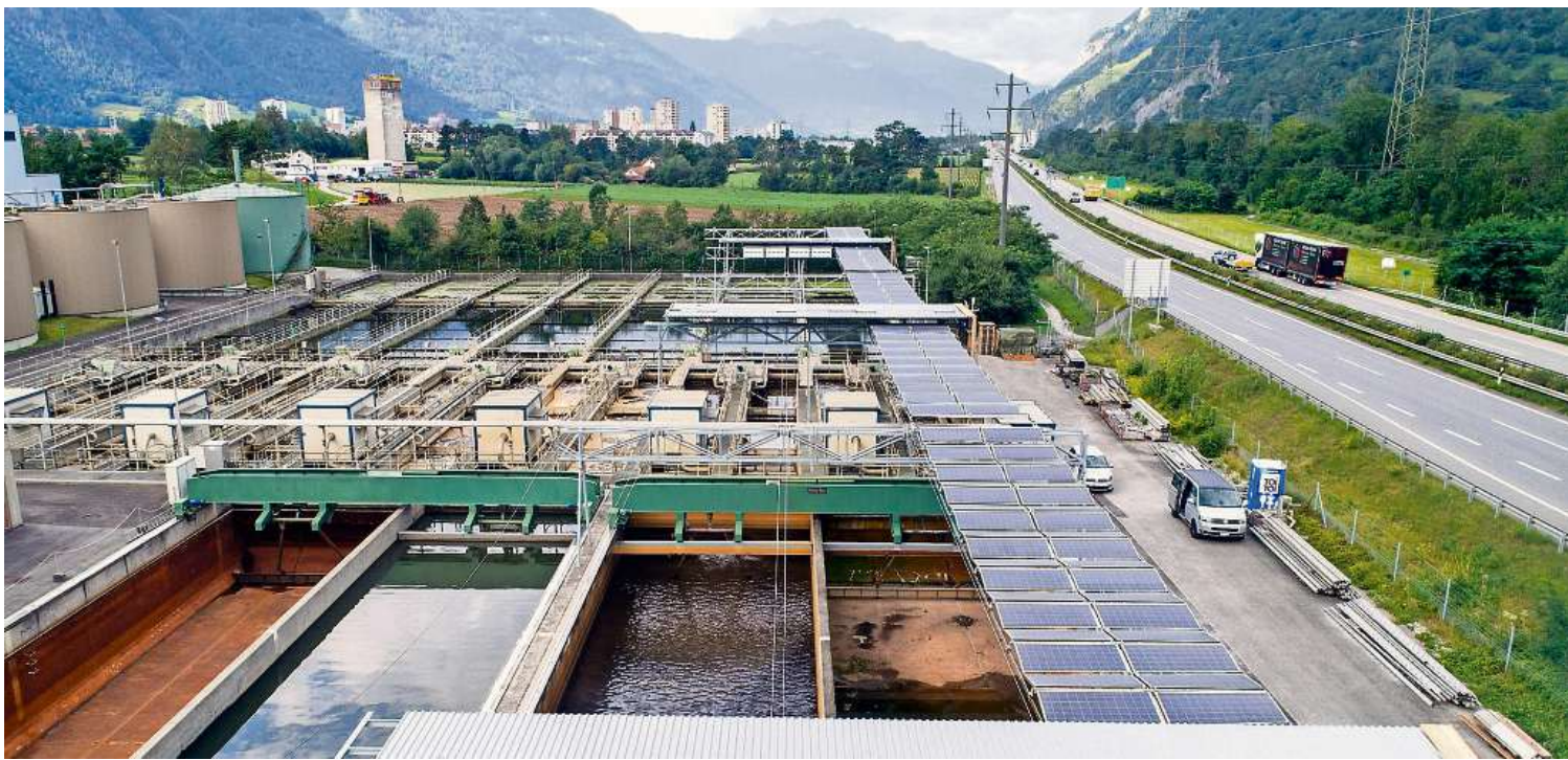
Das Solar-Faltdach produziert Ökostrom, der direkt vor Ort in der Abwasserreinigungsanlage Chur verbraucht wird. (FOTOS MARCO HARTMANN)
